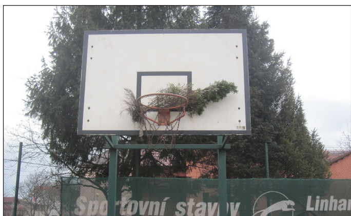
Následky vandalismu - je to opravdu nutné?
